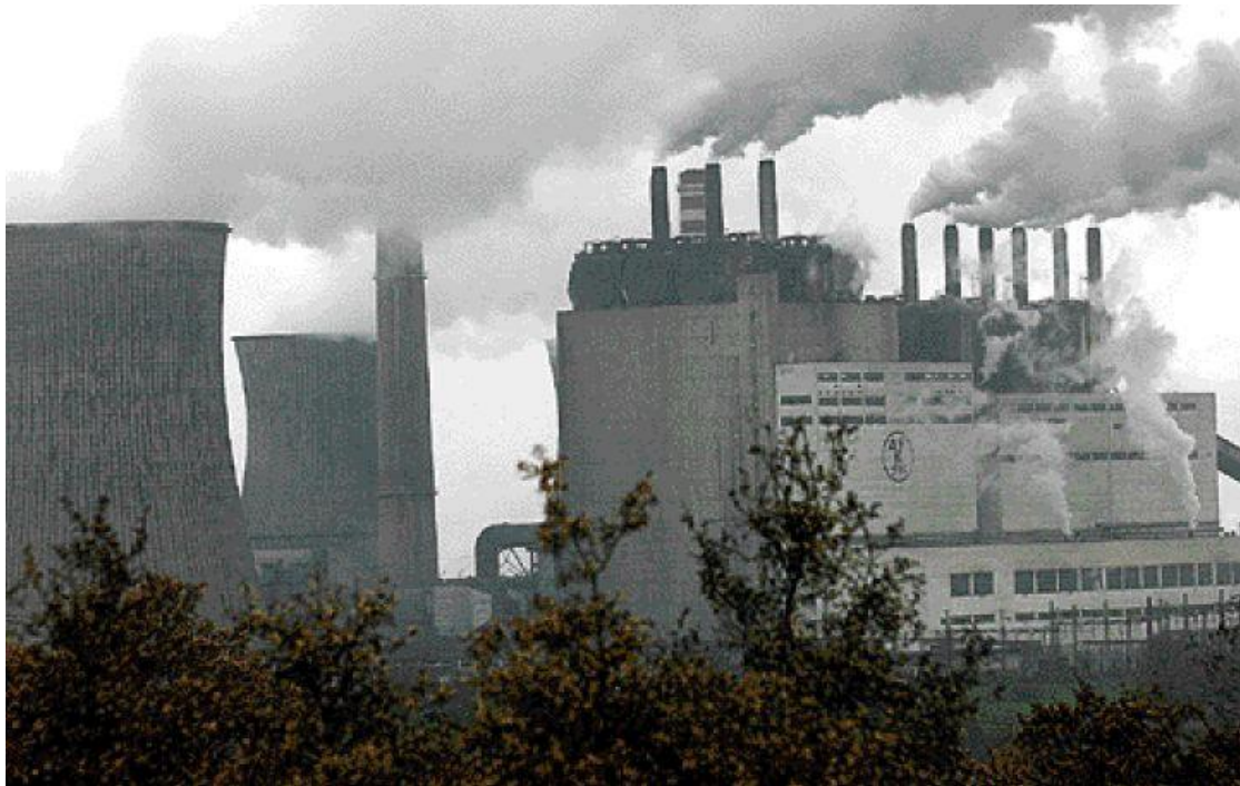
Ο ΑΗΣ (Ατμοηλεκτρικός Σταθμός ) Μεγαλόπολης , στην Πελοπόννησο
