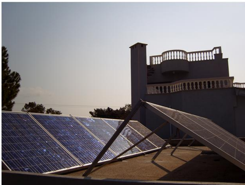
Διασυνδεδεμένο Σύστημα Ενεργειακού Συστήματος με Φωτοβολταϊκά Πλαίσια στην Ρόδο. Ισχύος 2,1 kWp
